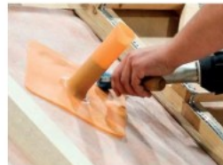
Étanchéité de la sous-couverture aux passages de câbles
